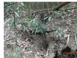
(c) 自然邊坡-張力裂縫1
