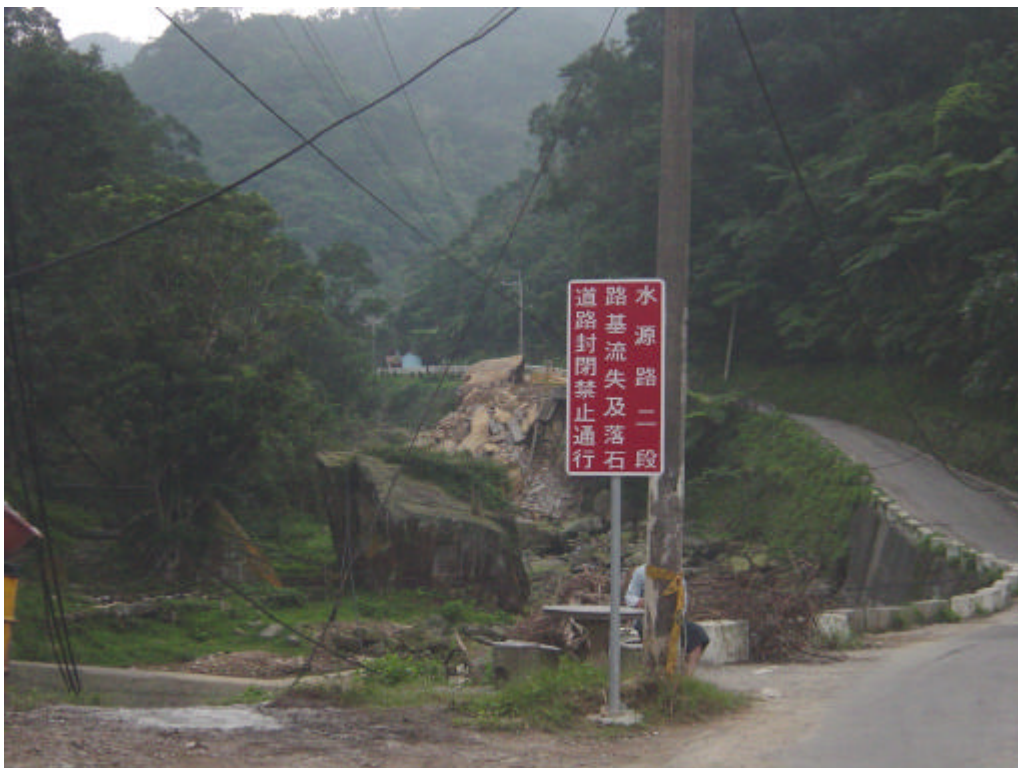
沿康誥坑溪往上游的水源路二段，路基已經流失崩壞，汽車無法繼續往前。
